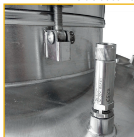
Vanne de sécurité
