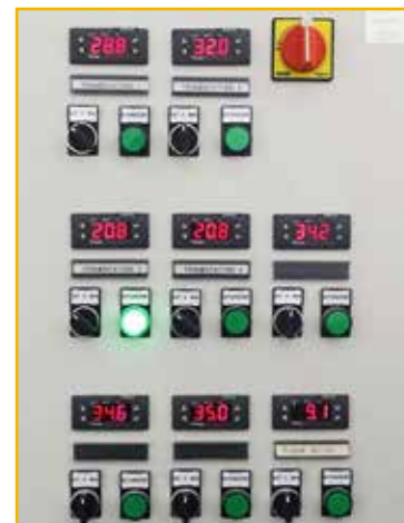
Quadro in funzione
