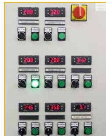
Quadro in funzione
