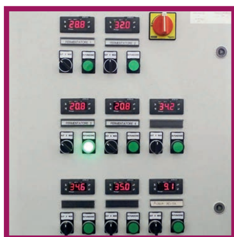
Quadro in funzione
