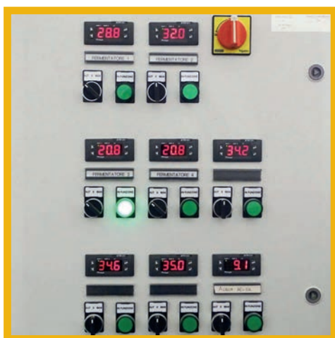
Quadro in funzione
